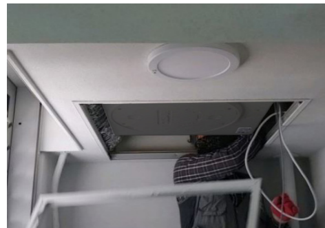
[ 천장 점검구 내 설치 ]
